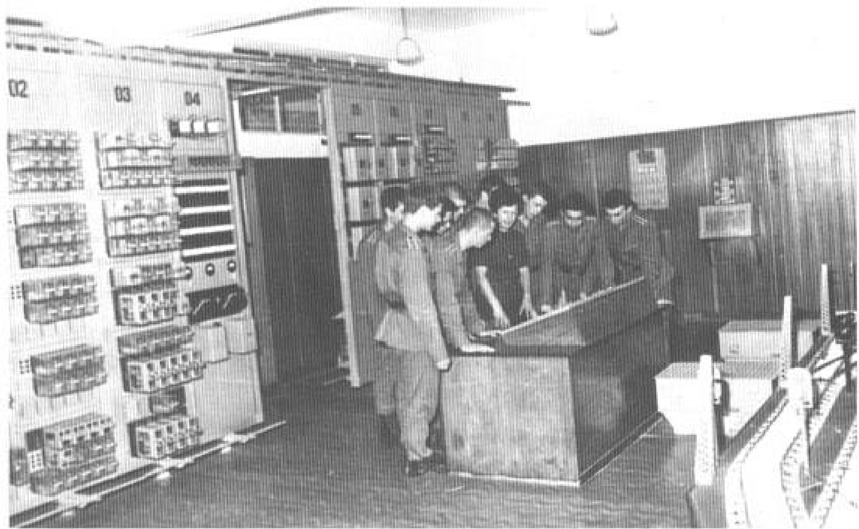
Кабинет по съобщителна и осигурителна техника и системи
